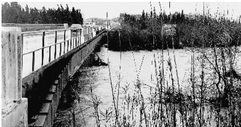
Una de les riuades del Manol al seu pas pel pont del Príncep amb l'aigua fregant el bigam del pont.
